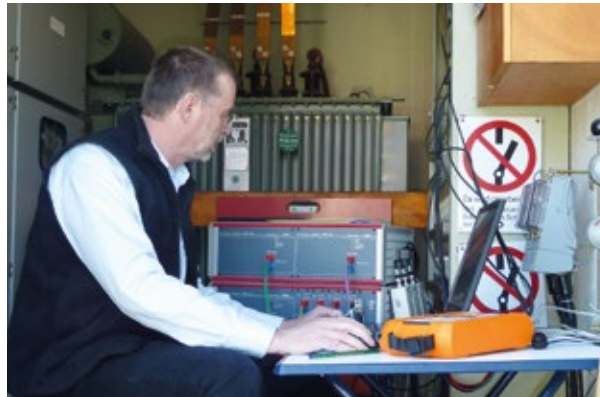
Messgeräteinsatz in einer Ortsnetzstation
