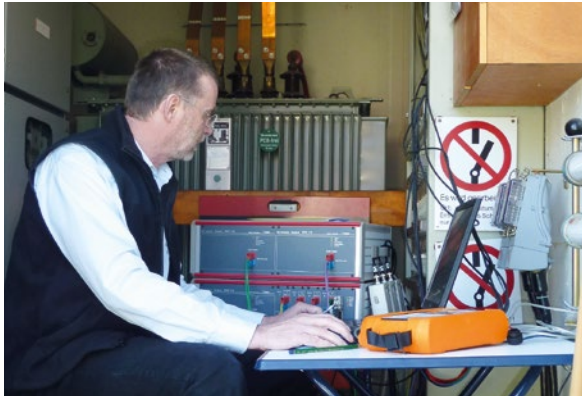
Messgeräteinsatz in einer Ortsnetzstation
